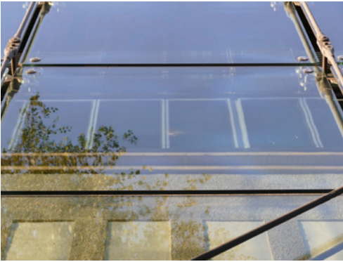
■ Abbildung 8: Die Erkennbarkeit von Anpralls Spuren hängt oft vom Lichteinfall und dem Betrachtungswinkel ab – hier ein Abdruck in der Mitte des Bildes. – The visibility of imprints often depends on the light and the angle of viewing. Here, an imprint in the image centre. Foto: W. Schulz
